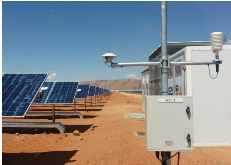
Abb. 4 – Einsatz von Pyranometern bei Photovoltaik Anlagen
